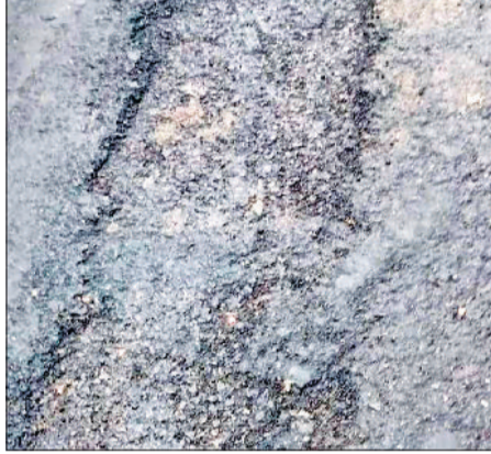
नई बनी सड़क के इस तरह उखड़ने से उठ रहे सवाल।
